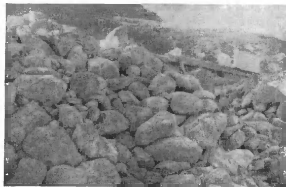
Рис. 3. Занесенный селевым потоком мост
